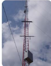
Panneaux photovoltaïques (les 2 au milieu) et boîtiers d'enregistrement (de part et d'autre)
